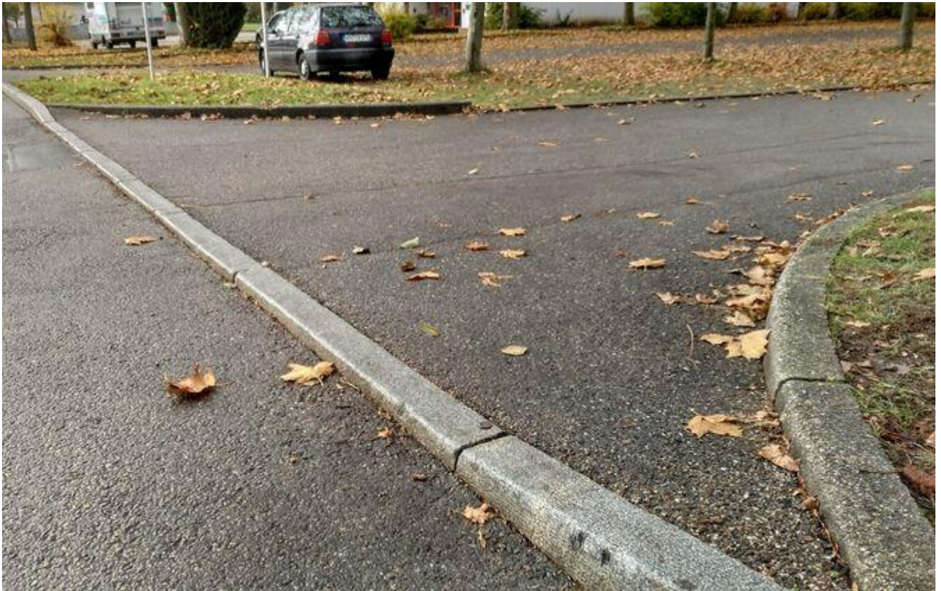
Talaue Birkmannsweiler: „Abgesenkte Bordsteine sind zu hoch für Radler, Rollstuhlfahrer und Rollatorenschieber. © Sukowski/adfc
